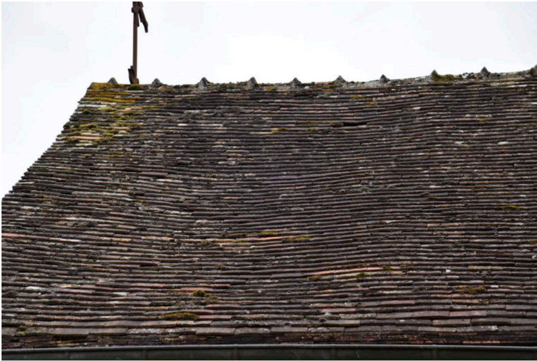
Couverture dont il convient d'évaluer l'état avec des parties incurvées en fléchissement et des tuiles cassées manquantes.
