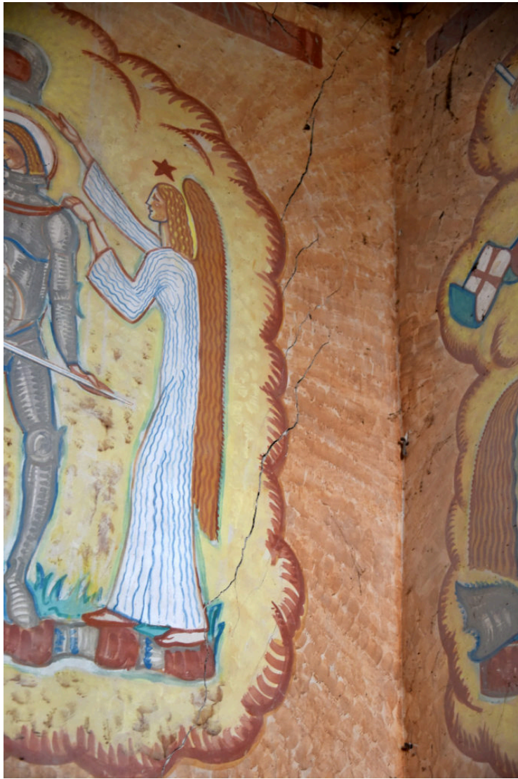
Fissures à l'intérieur sur les peintures murales.
