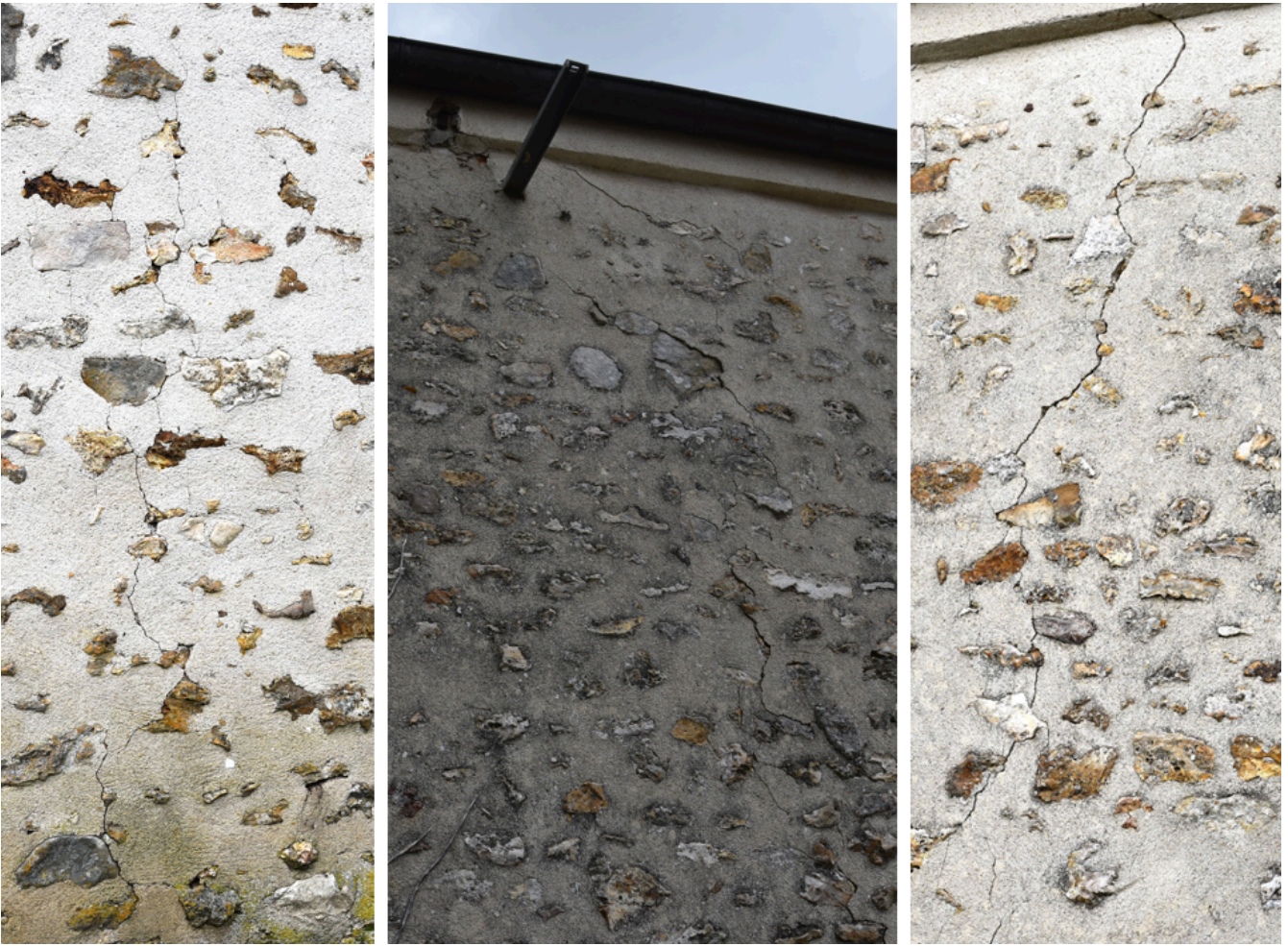
Fissures extérieures de faible amplitude et semble-t-il peu évolutives.
