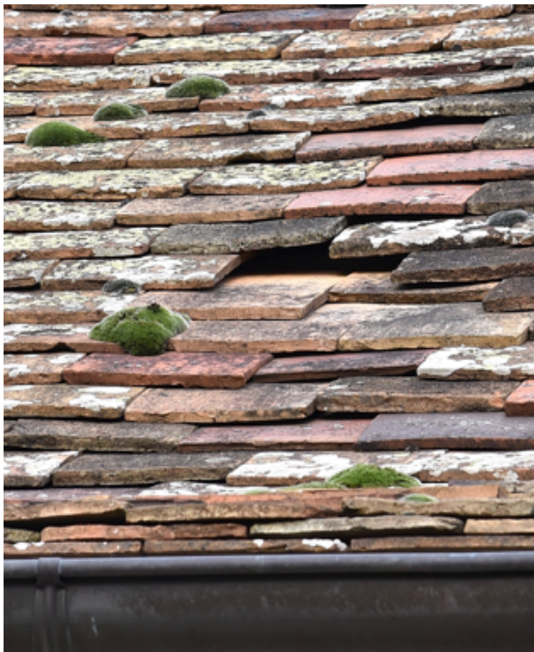
Exemple de tuile manquante à remplacer
