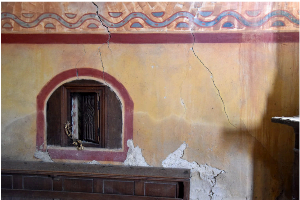
Fissures au niveau des décors peints et délitement des enduits supports.
