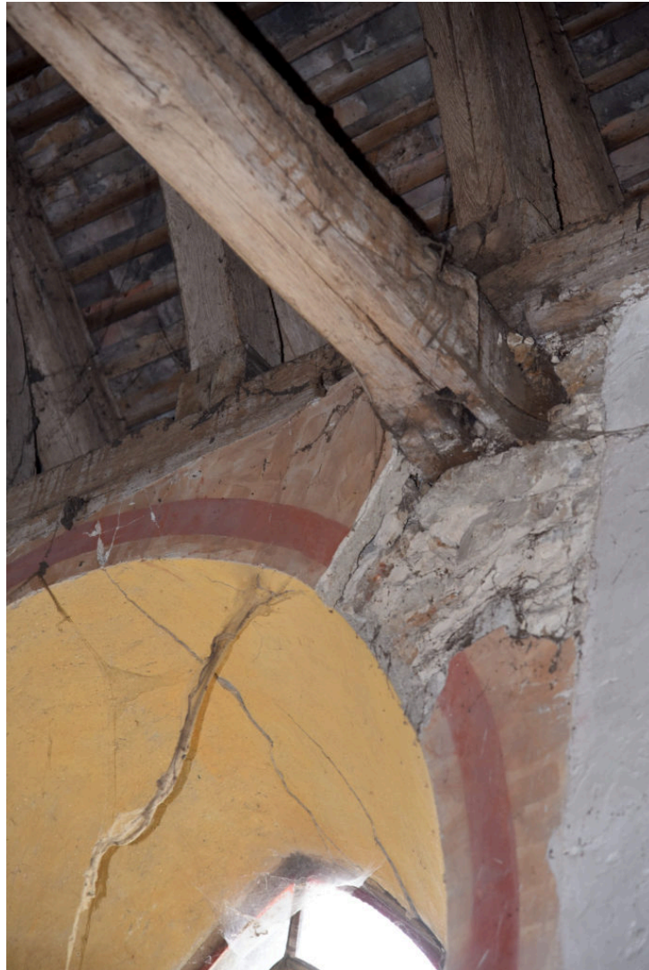
Eclatement de l'enduit au droit de l'appui de la charpente.
