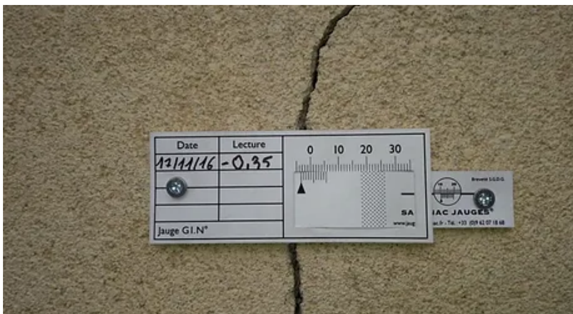
Exemple de jauge posée sur une fissure.
