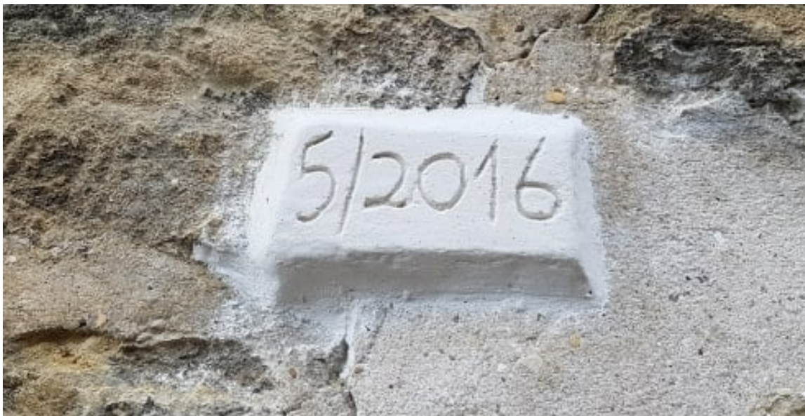
Exemple de témoin plâtre posé sur une fissure.
