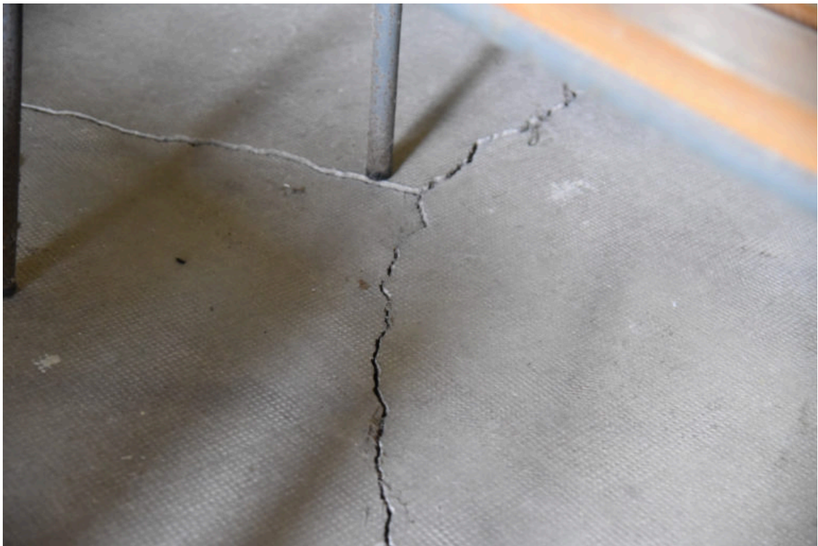
Fissure en étoile.
