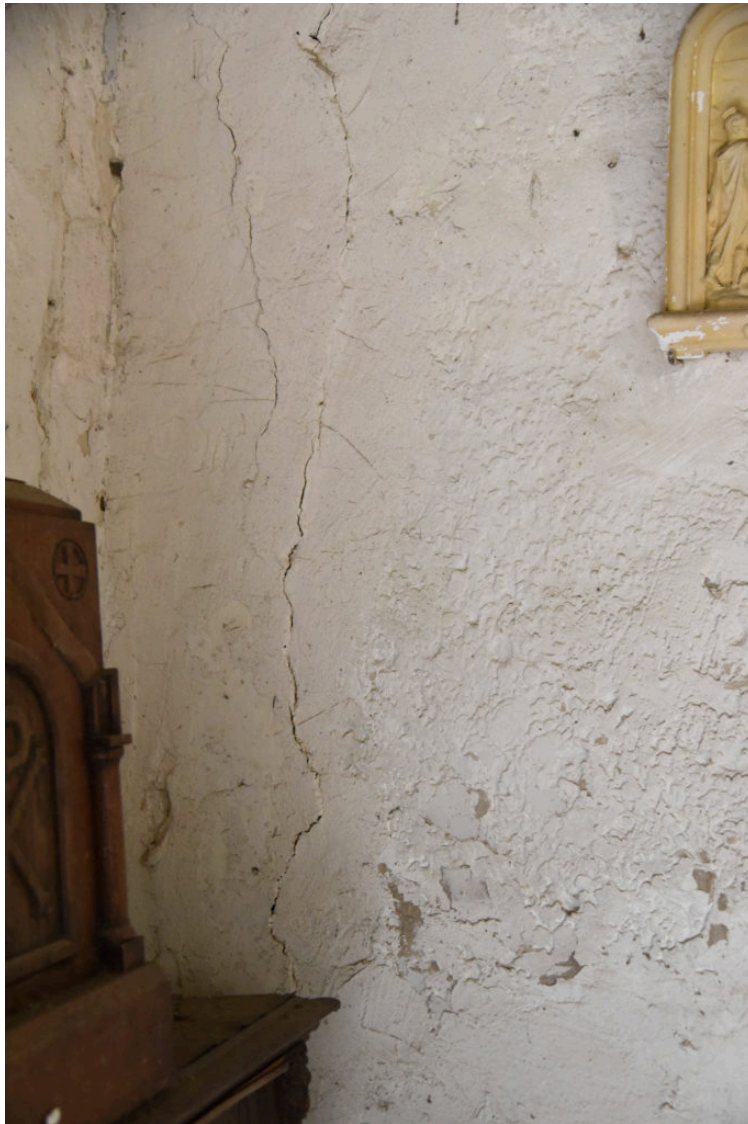
Autre fissure sur mur enduit à la chaux.
